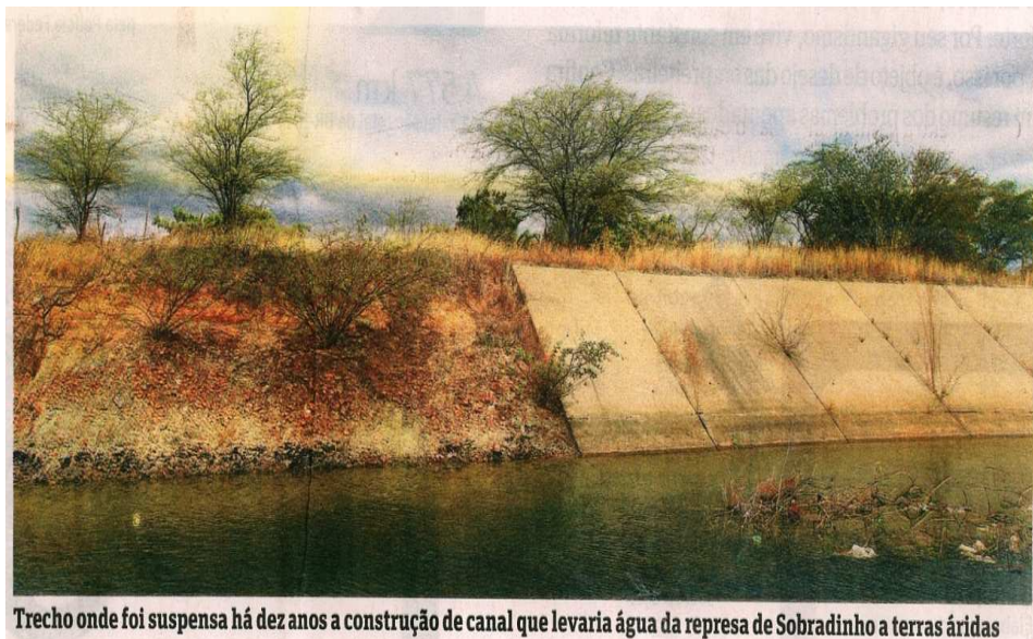
Figura 6.3 - Leito seco em canal que levaria água da represa do Sobradinho na Bahia.
