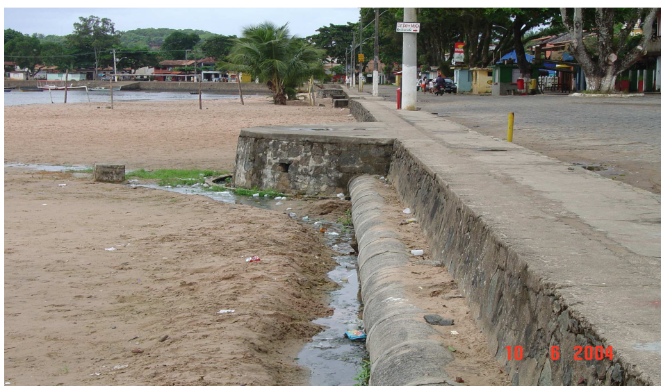
Figura 06: Emissão de esgoto a céu aberto em local
