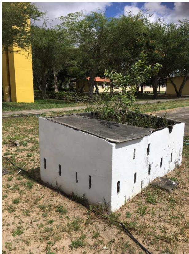
Figura 3.3 – Local do poço semi-artesiano (Fonte: AUTOR, 2017)
