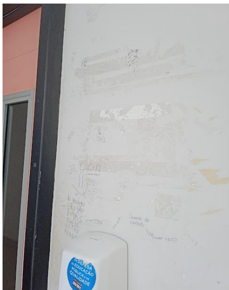
Figura 8 – Marcas de riscos a lápis e resquícios de adesivo nas superfícies do revestimento argamassado em parede de um dos corredores do Pavilhão de Aulas I.
