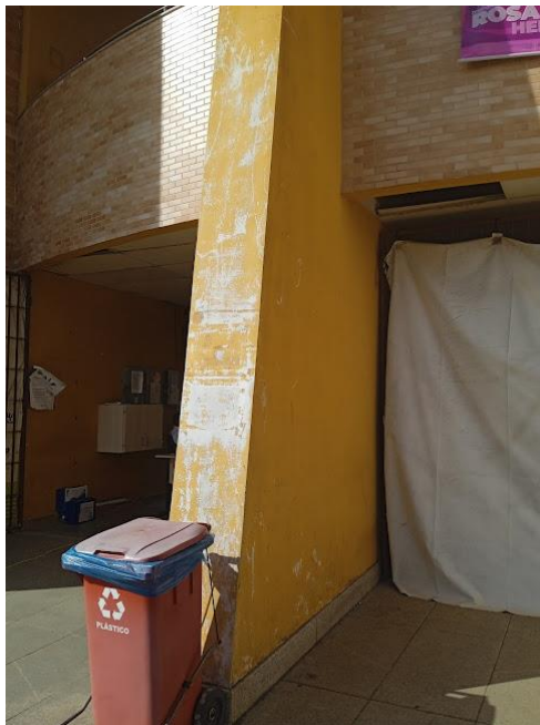
Figura 11 – Pintura danificada por possíveis cartazes anexados com material adesivo e retirados posteriormente em área externa do Pavilhão de Aulas I.
