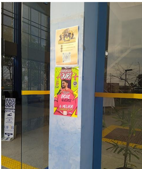
Figura 22 – Marcas de fita adesiva em parede externa da edificação da Biblioteca.
