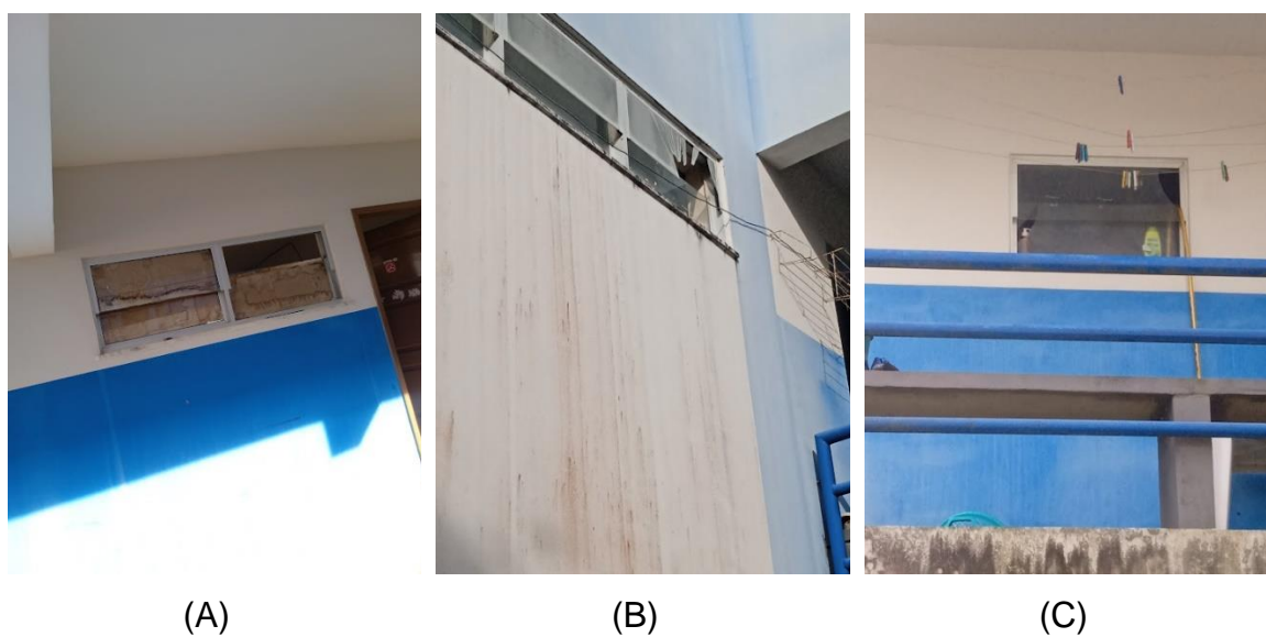
Figura 31– Lâminas em vidro de basculantes quebradas.
