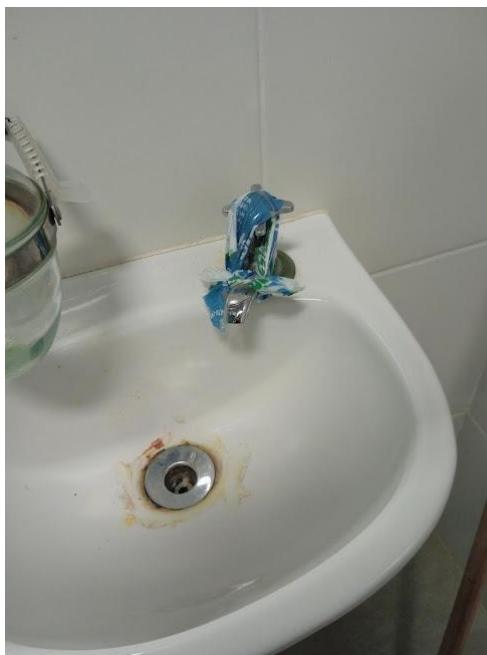
Figura 16 – Pia interditadas, com problemas de retorno, em um dos banheiros da edificação do NUGTESP.
