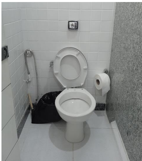
Figura 24 – Assento de bacia sanitária danificado e solto.
