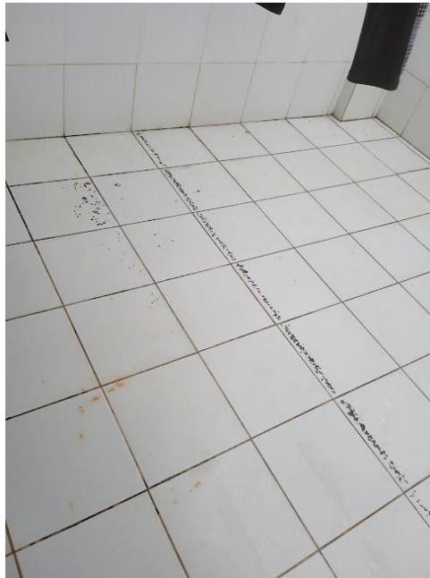
Figura 26 – Piso cerâmico com marcas de ferrugem e umidade
