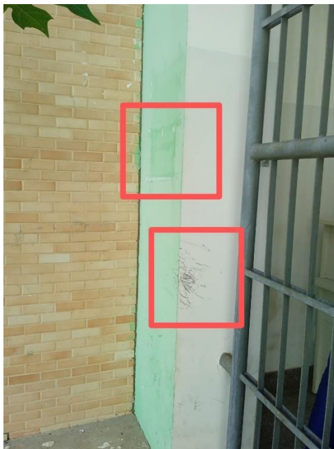
Figura 19 – Arranhões nas superfícies do revestimento argamassado na parede externa, possivelmente provocados por bicicletas encostadas, e resquícios de adesivo proveniente de colagem de cartazes.
