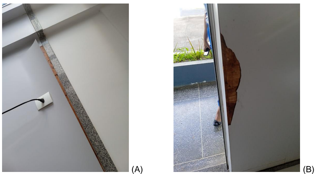
Figura 30 – Compensado danificado utilizado por cima de revestimento argamassado.
