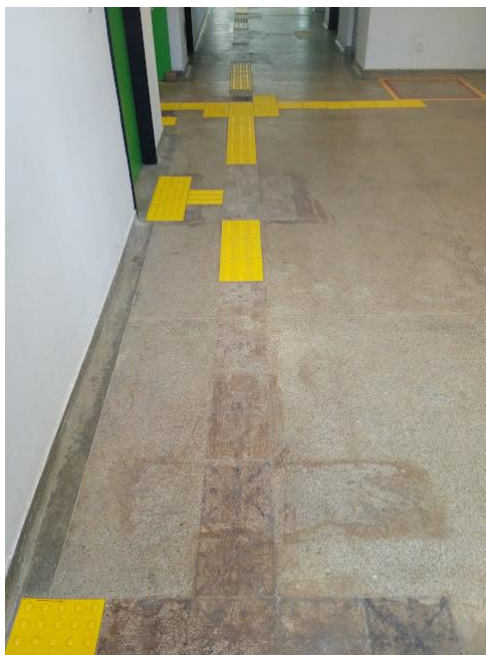
Figura 20 - Piso tátil direcional com partes removidas no corredor da edificação do NUGTESP.
