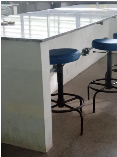
Figura 18 – Marcas de solados de calçados dos usuários em balcão de laboratório da edificação do NUGTESP.
