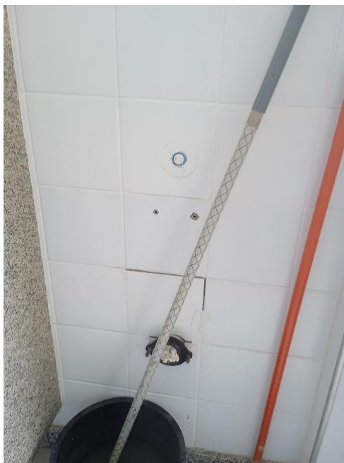
Figura 12 - Componente da bacia sanitária removido em um dos banheiros do Pavilhão de Aulas I.
