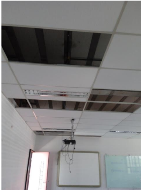
Figura 10 - Áreas no teto sem placas de forro em uma das salas de aula do Pavilhão de Aulas I.
