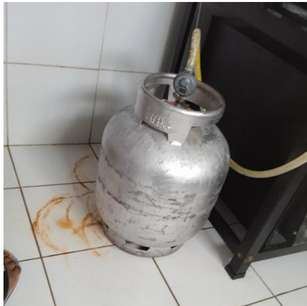
Figura 29 – Marcas ferrugem no revestimento cerâmico do piso da cozinha.
