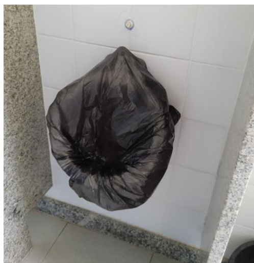
Figura 13 - Mictório interditado em razão de peça danificada em um dos banheiros do Pavilhão de Aulas I.
