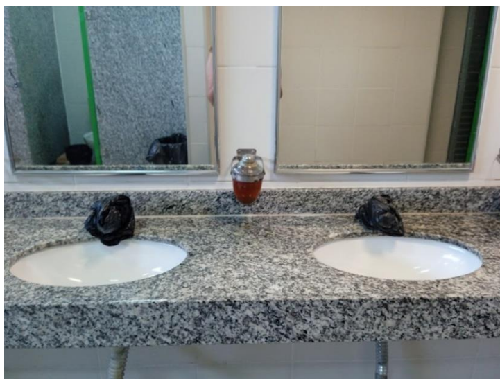
Figura 17 – Pias interditadas, com sifão danificado, em um dos banheiros da edificação do NUGTESP.
