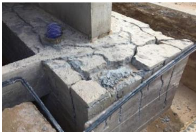
Figura 1: Bloco fissurado devido a RAA.
