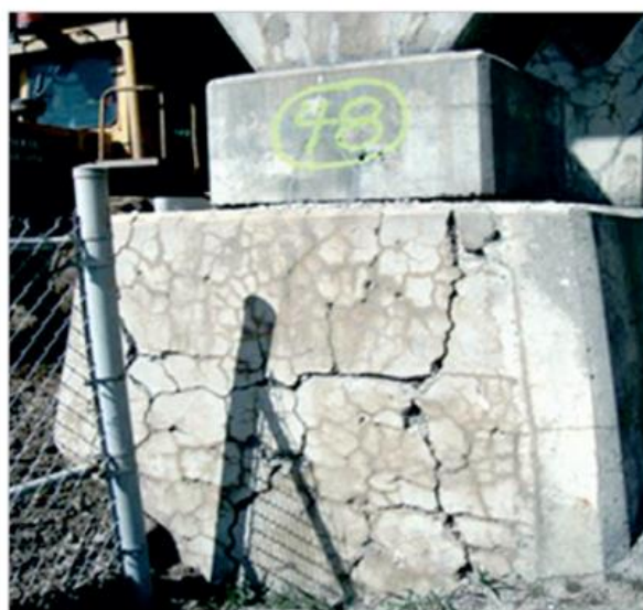
Figura 3: Fissuras provocadas pela RAS em bloco de fundação do viaduto Robert-Bourassa em Charest, cidade de Quebec no Canadá.
