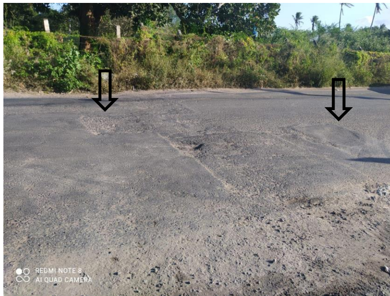
Figura 36: Remendo e desagregação superficial
