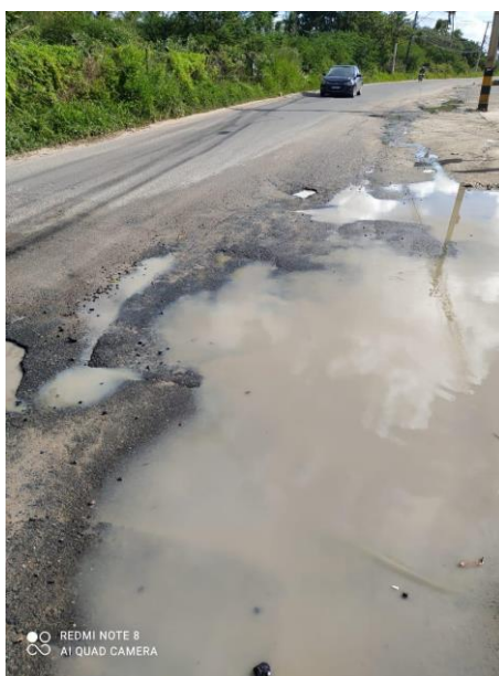
Figura 34: Ausência de elementos de drenagem
