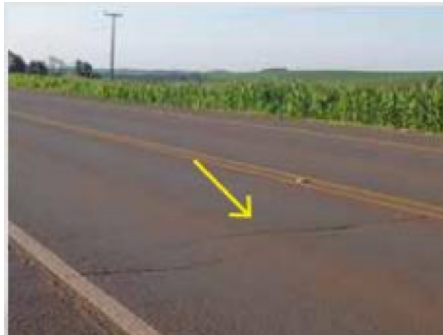
Figura 15: Trinca transversal longa
