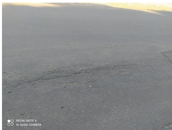
Figura 32: Trinca longitudinal e Afundamento local
