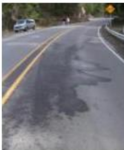
Figura 22: Mancha de umidade
