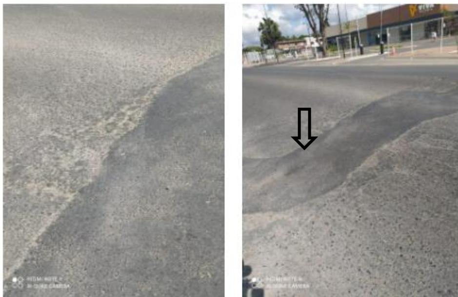
Figura 35: Remendo e afundamento local
