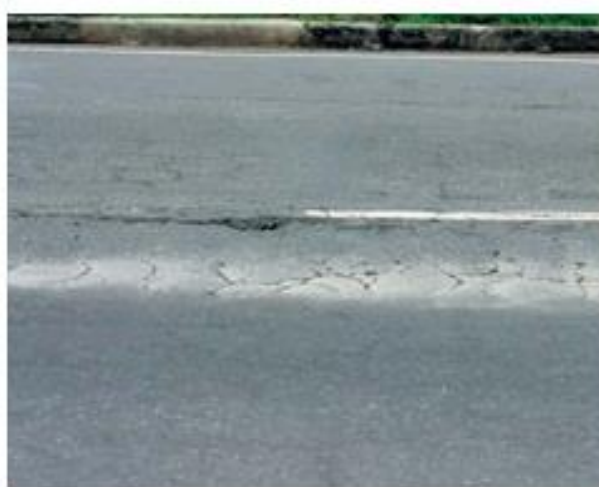
Figura 23: Bombeamento de finos
