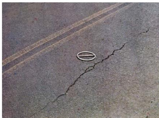
Figura 16: Trinca longitudinal longa
