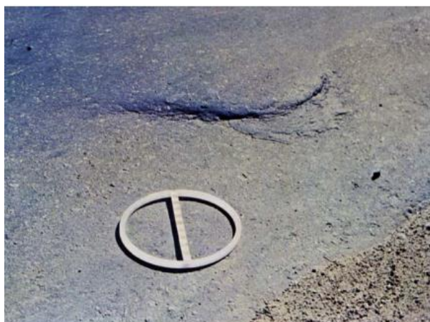
Figura 11: Escorregamento subjacente do pavimento
