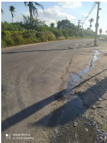
Figura 38: Ausência de elementos de drenagem
