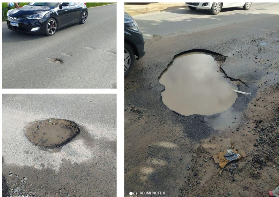
Figura 31: Desagregações Superficiais e Panela/buraco
