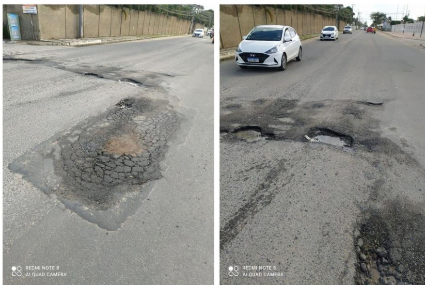
Figura 29: Afundamento local, trinca interligada “couro de jacaré”, panela/buraco e remendo
