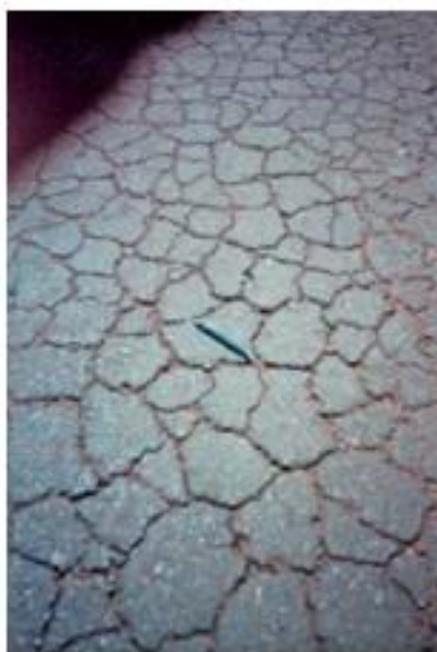
Figura 18: Fendilhamento tipo “Couro de jacaré”
