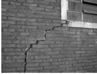
Figura 2.5: Rachadura em alvenaria provocada por recalque do solo abaixo da edificação Fonte: Rodrigues, 2008
