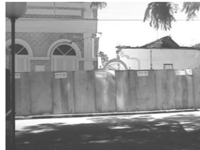
Figura 2.8: Desabamento de edificação causado por deformações induzidas por colapso de solo Fonte: Cerri, 2008
