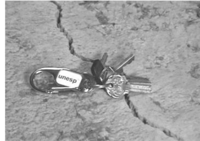
Figura 2.6: Trinca em laje de concreto Fonte: Segantini e Rodrigues, 2008
