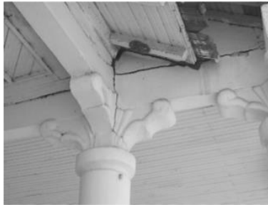
Figura 2.7: Trinca em elemento estrutural de pequena edificação devida a processo de colapso do solo Fonte: Rodrigues, 2008
