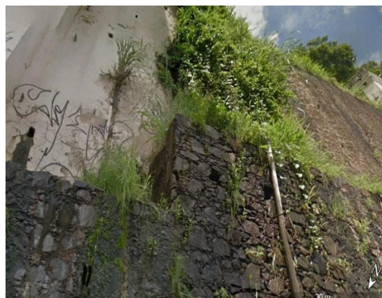
Figura 9 – Presença de plantas, tubulações e umidade no marcador 13
