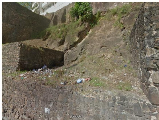
Figura 12 – Início da mobilização do maciço rochoso no Marcador 20
