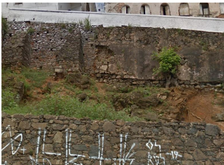
Figura 11: Corresponde ao deslocamento da alvenaria e do maciço no marcador 20
