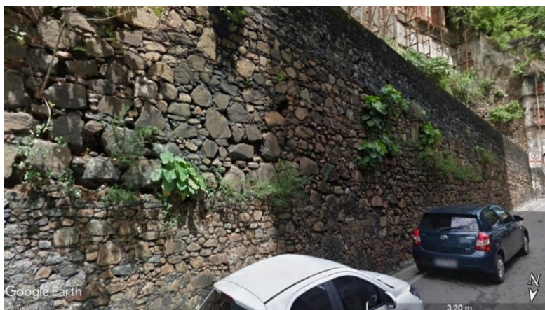
Figura 10: Presença de plantas espontâneas com deterioração da argamassa - Marcador 2
