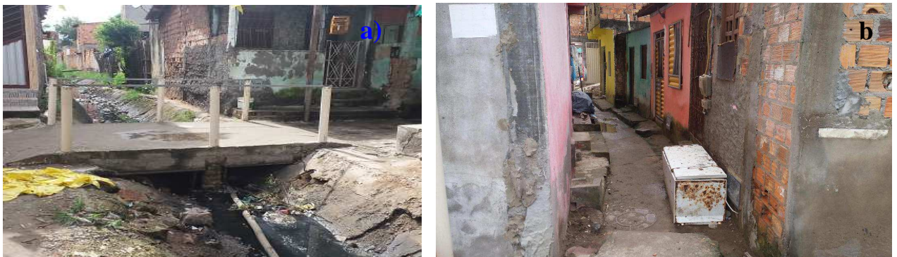
Figura 11. a) Ponte improvisada sobre o canal de esgoto no bairro Trapiche de Baixo, cidade de Santo Amaro 13 de julho de 2018; b) Viela estreita para circulação de pedestres no bairro Trapiche de Baixo, cidade de Santo Amaro. Fonte: Arquivo da autora, 13 de julho de 2018.
