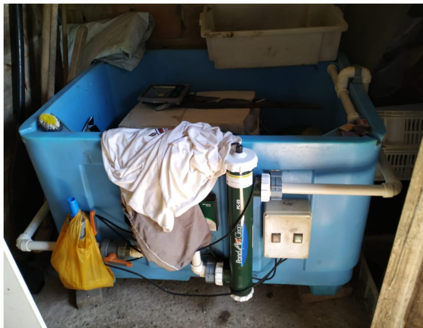
Figura 16. Depuradora do cultivo sem utilização
