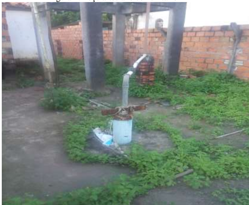
Figura 4: Poço artesiano comunitário
