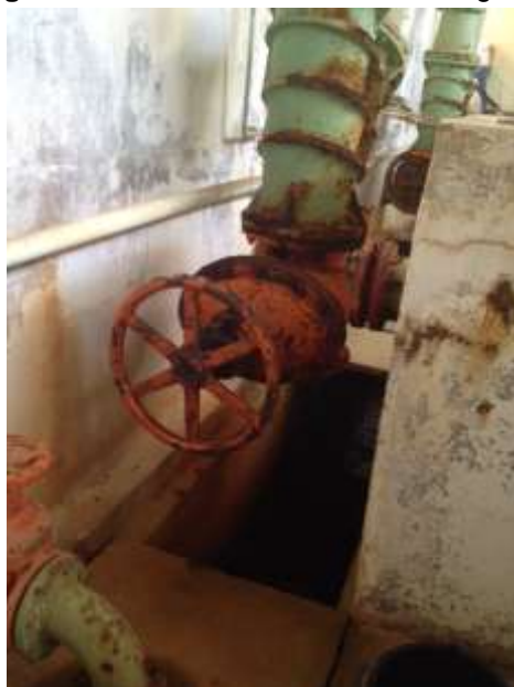
Figura 4.5 - Válvula do filtro com ferrugem
