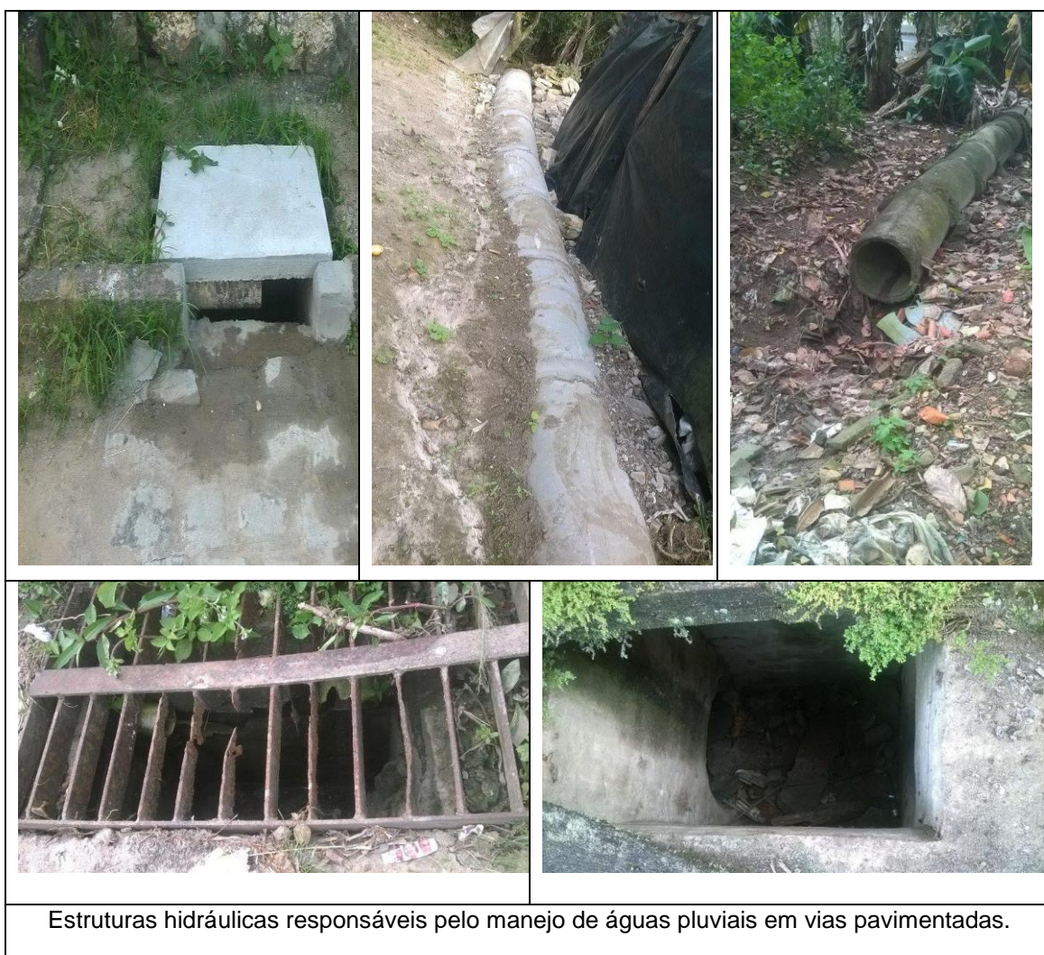
Figura 3 – Registros da drenagem de águas pluviais em vias pavimentadas na comunidade Sapucaia
