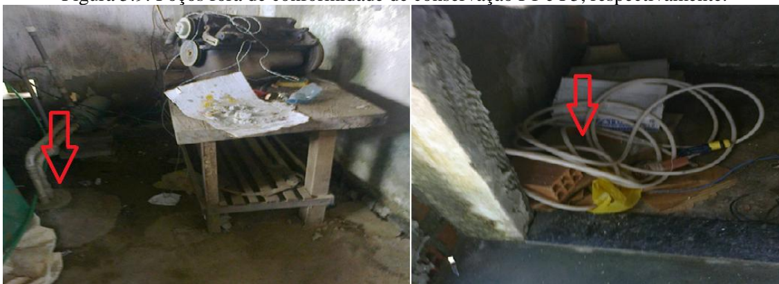
Figura 5.9: Poços fora de conformidade de conservação P1 e P5, respectivamente.
