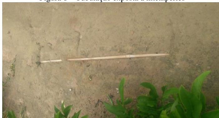
Figura 8 – Tubulação exposta à intempéries
