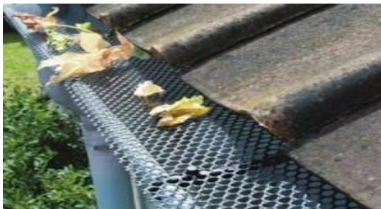
Figura 12 - Tela para retenção de sólidos
