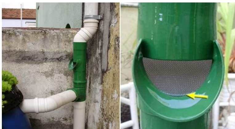
Figura 13 - Filtro nas tubulações
