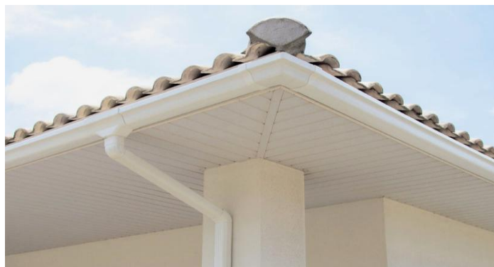
Figura 10 – Calha e condutor vertical para recolher água de chuva
