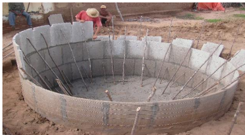
Figura 19 - Reservatório de placa de cimento
