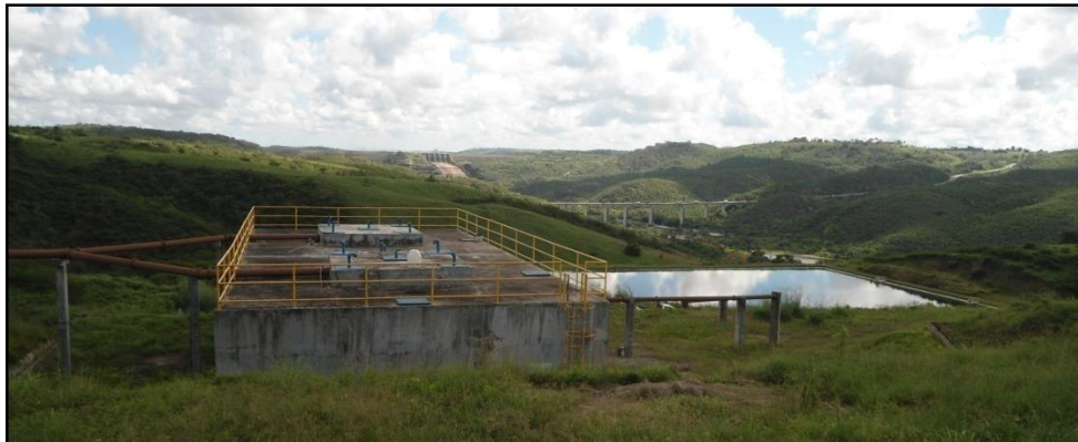
Figura 13. Estação de tratamento de esgoto da EMBASA/ Muritiba - BA.
