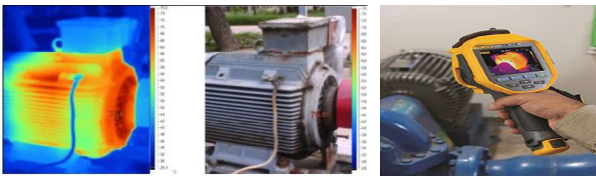
Figura 5 - Termografia aplicada à um motor elétrico com uma câmera térmica
