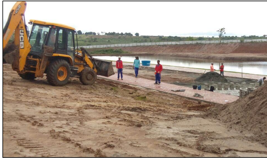
Figura 4: Movimentação de terra por máquinas durante as obras no segundo açude (Autor, 2018).
