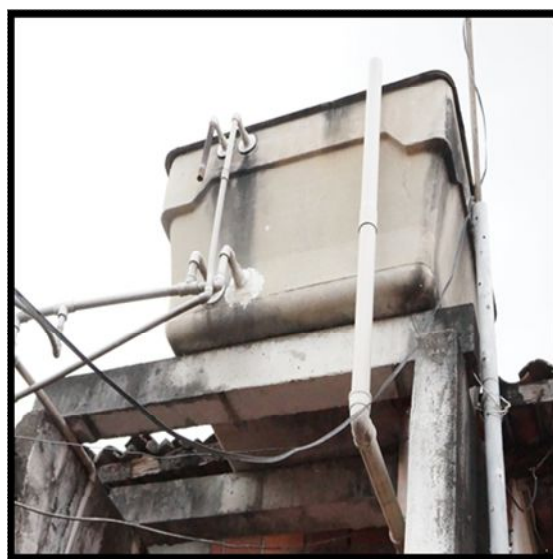
Figura 3: Reservatório de cimento-amianto
