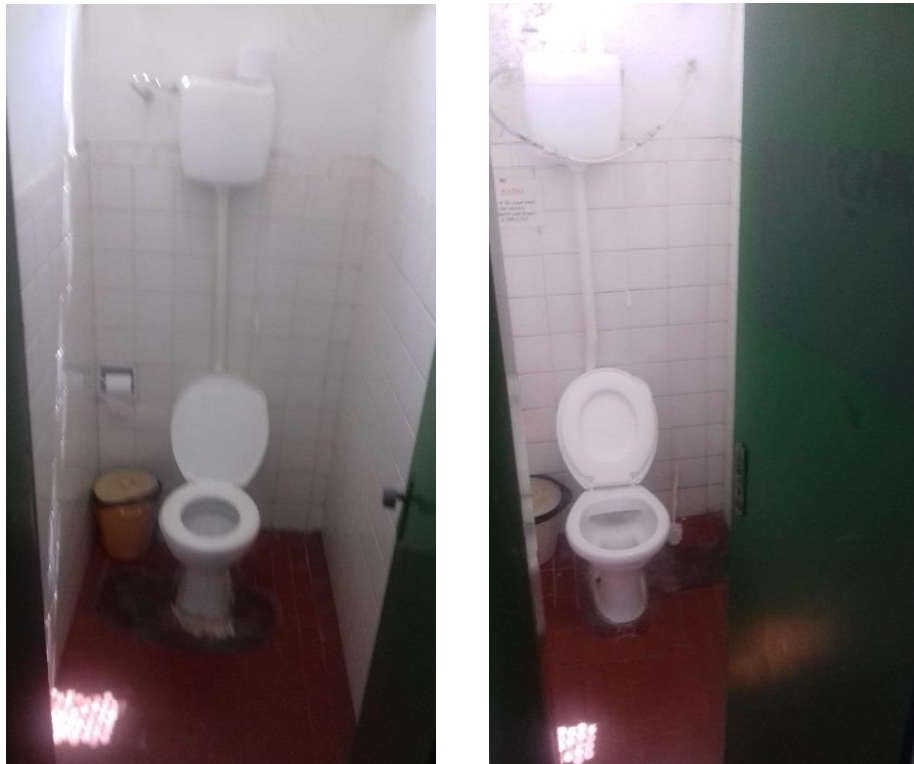
Figura 31- Bacias sanitárias sem barras de apoio.
