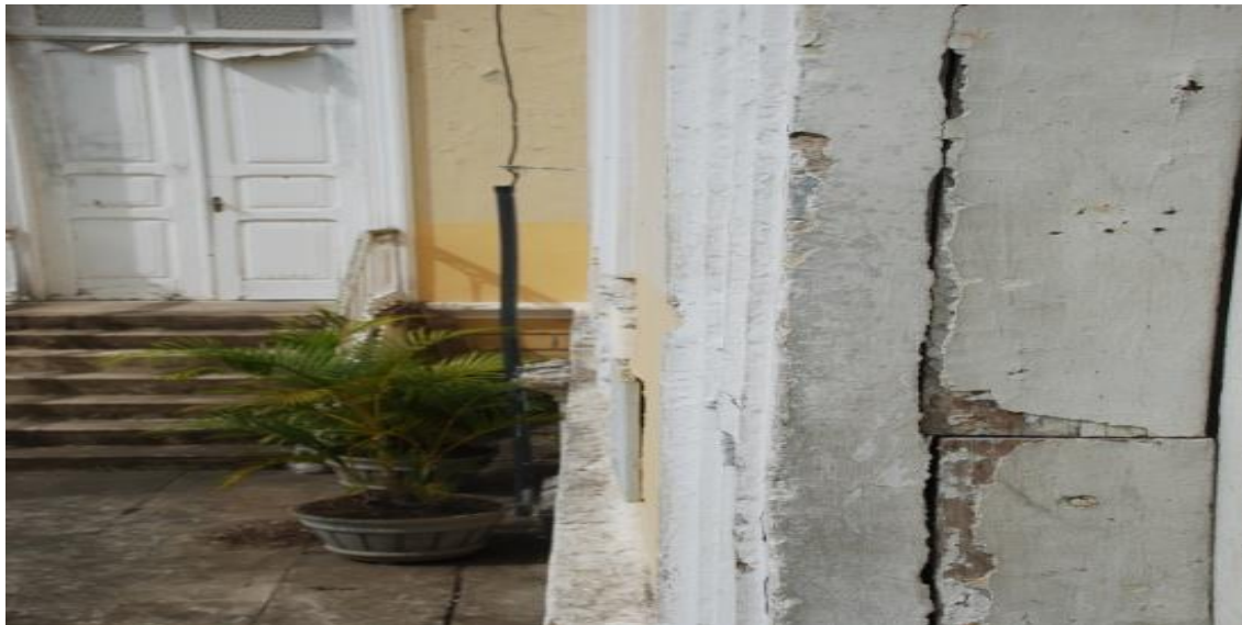
Figura 11 : Desgaste para fissuras na parte estrutural -2013.
