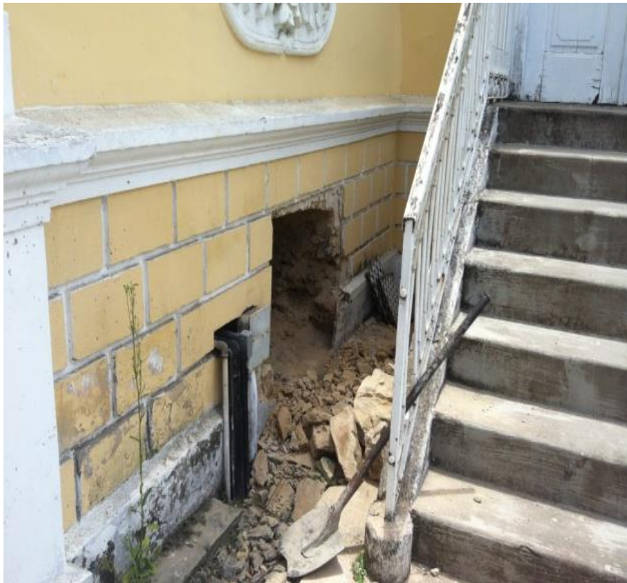
Figura 13: Detalhe de desgaste estrutural 2013.
