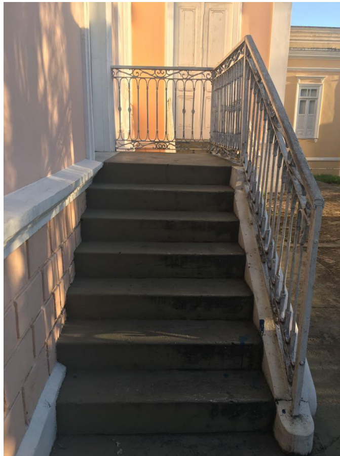
Figura 24: Guarda corpo da escada de acesso aos fundos do prédio.
