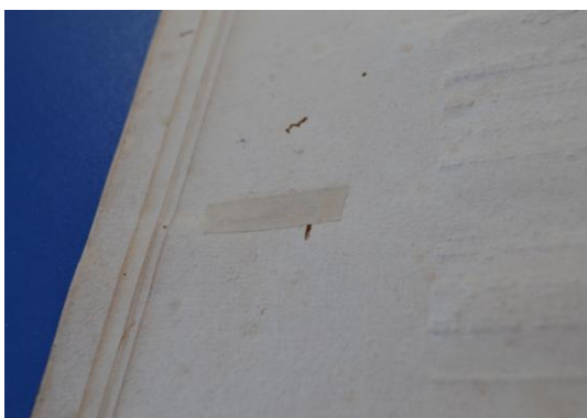
Figura 13 – Reparo na obra com recorte de papel colados. Foto: Thais Vaz.
