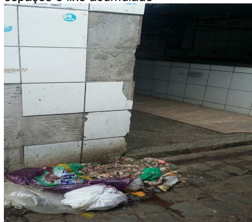
Figura 21 - Falta de conservação dos espaços e lixo acumulado
