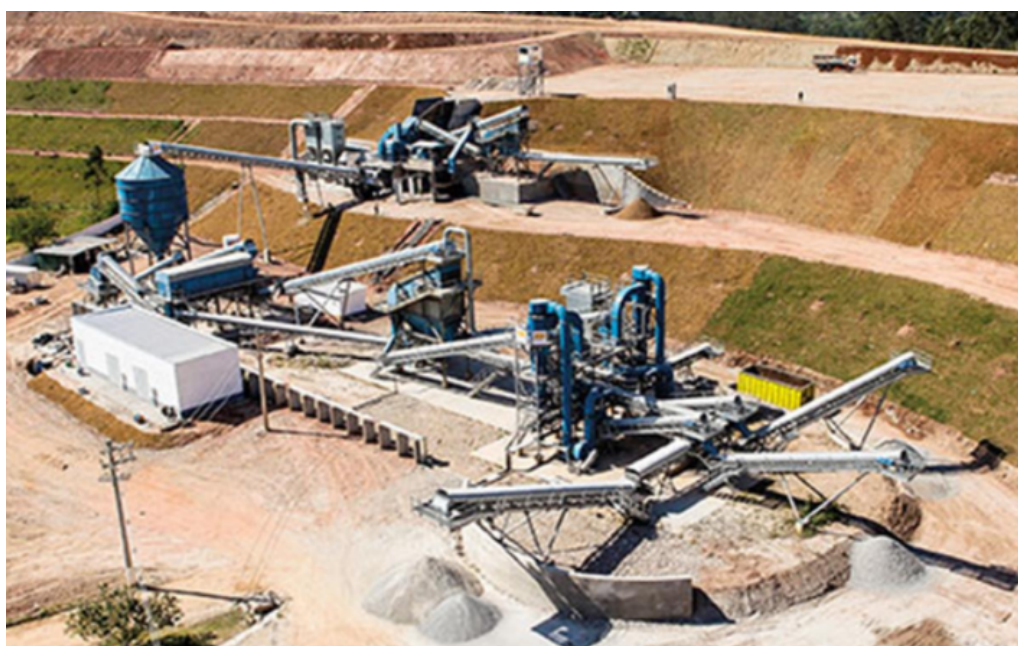
Figura 2 – Usina de Reciclagem RCC com Planta Fixa
