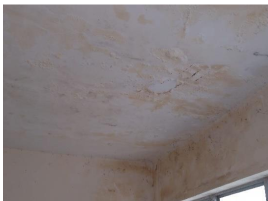
Figura 01 – Teto do vão da Escada
