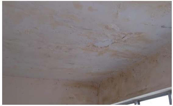
Figura 20 – Teto do vão da Escada
