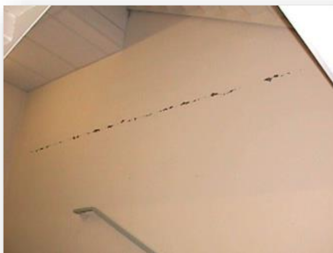
Figura 10: Fissura horizontal. (Fonte: FREITAS; FRANÇA; FRANÇA, 2013).
