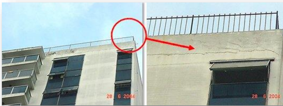
Figura 6: Fissuras isoladas (Fonte: SAHADE, 2020)
