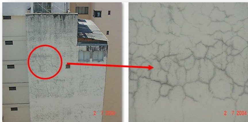
Figura 7: Fissuras disseminadas (Fonte: SAHADE, 2020).
