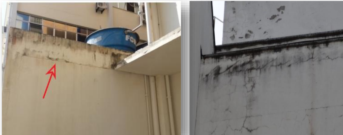
Figuras 11 (a), (b): Fissuras causadas por retração térmica.
