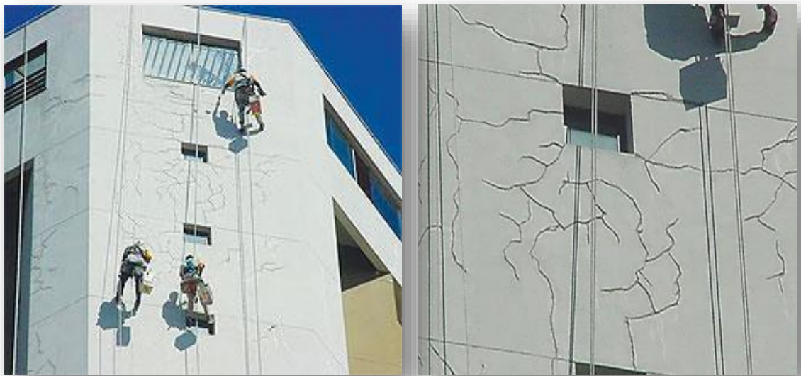
Figuras 12 (a), (b): Fissuras de retração por secagem. (Fonte: CORSINI, 2010; SAHADE, 2020)
