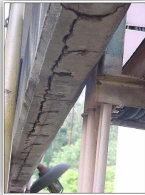
Figura 17: Fissuras causadas pela expansão de óxidos produzidos pela corrosão.
