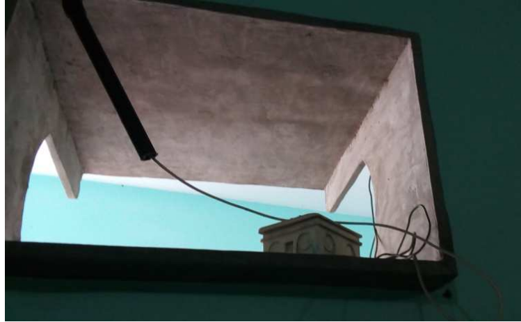
Figura 33 - Abertura para ar-condicionado na sala de trabalho do Projeto CEC Ano – 2018 / Foto: Renata Teles
