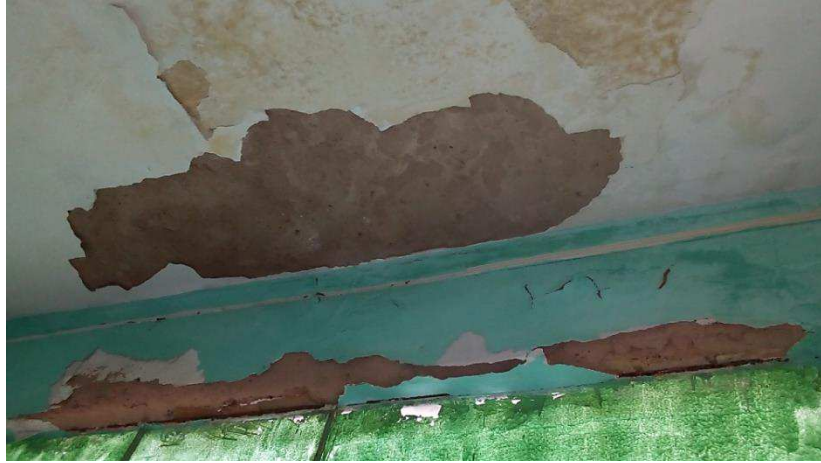
Figura 24 - Desgaste da pintura causado por infiltrações (Pavilhão Rômulo Galvão) Ano 2018 / Foto: Renata Teles
