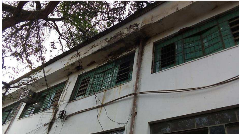
Figura 25 - Prédio do Pavilhão Rômulo Galvão apresentando infiltrações e instalações elétricas inadequadas - Ano 2018 Foto: Renata Teles
