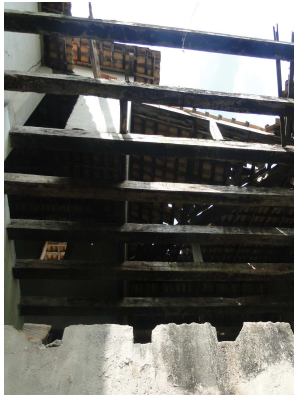
Figura 327. Vista do estado atual do assoalho e telhado da casa sede. Fonte: Renata Ramos / 2012
