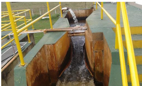
Figura 3.4: Calha Parshall da ETA de Santo Antônio de Jesus
