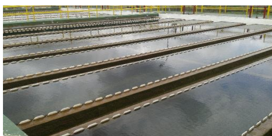
Figura 3.6: Unidade de decantação da ETA de SAJ.
