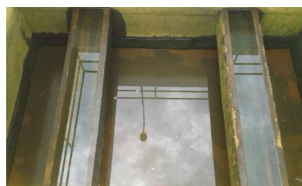
Figura 3.7: Filtro rápido desativado para lavagem na ETA de SAJ.
