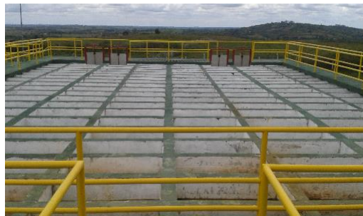
Figura 3.5: Floculadores de fluxo vertical da ETA de SAJ
