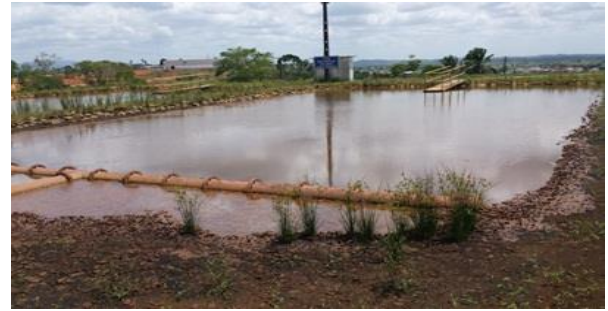
Figura 3.10: Lagoa de decantação da ETA – SAJ Fonte: Menezes, 2015.
