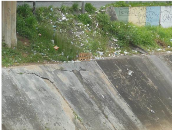
Figura 5.27 - Resíduos sólidos na margem do rio, próximo da Estação de Transbordo.
