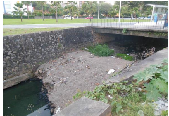
Figura 5.38 - Represamento do rio em função da pequena vazão do rio Camarajipe.
