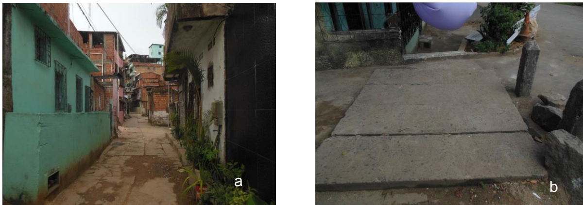
Figura 5.6 - Córrego canalizado e ocupação desordenada do solo (a) e Placas removíveis (b).
