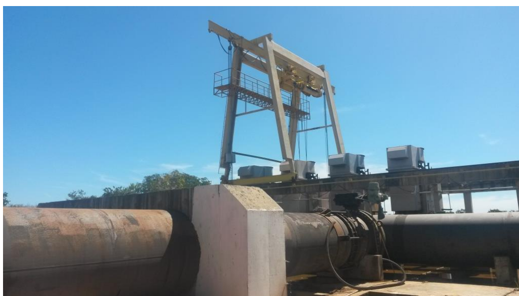
Figura 4.8: Sistema de bombeamento do Projeto Formoso A
