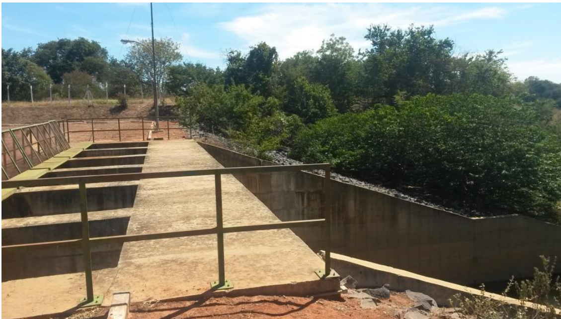
Figura 4.7: Ponto de captação de água do rio Corrente para o Projeto Formoso H.
