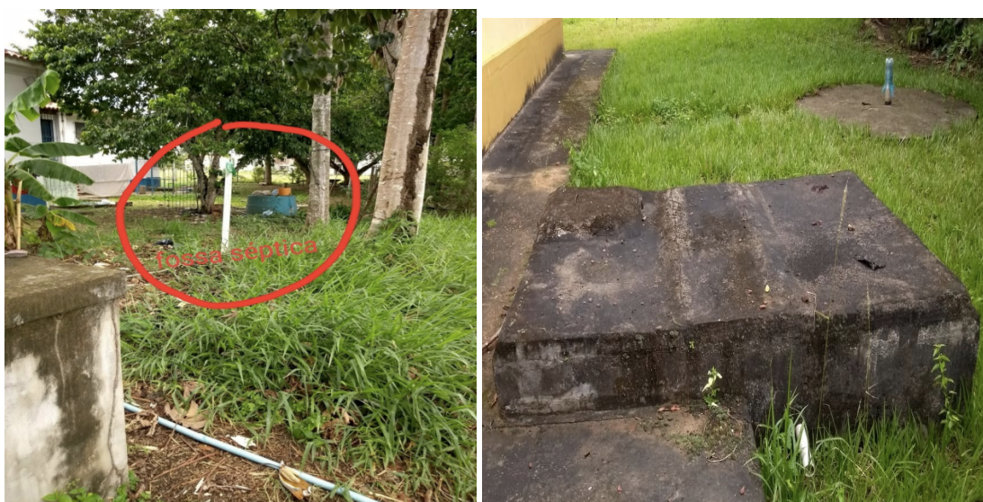
Figura 17: Fossas sépticas instaladas próximas ao reservatório – 2018
