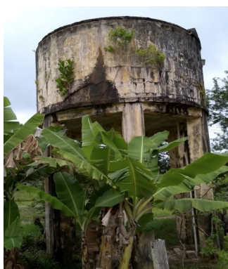
Figura 12: Reservatório de distribuição - RU/Residência Trio Elétrico – 2018
