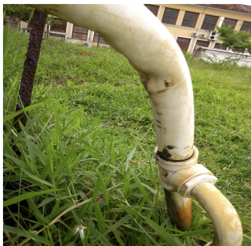
Figura 9: Tubulação com abaulamento - unidade prédio de solos – 2018
