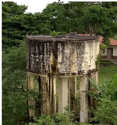
Figura 11: Reservatório de distribuição - Unidades RU/Residência – 2018
