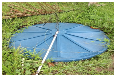
Figura 2: Reservatório de polietileno enterrado no solo – 2018
