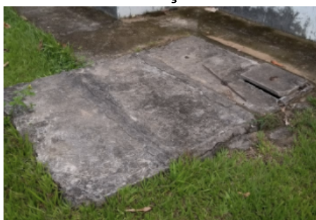
Figura 15: Reservatório de distribuição – SUPAI/Casa dos DAS - 2018
