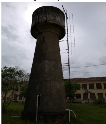
Figura 8: Reservatório de distribuição superior - Unidade Prédio de Solos - 2018
