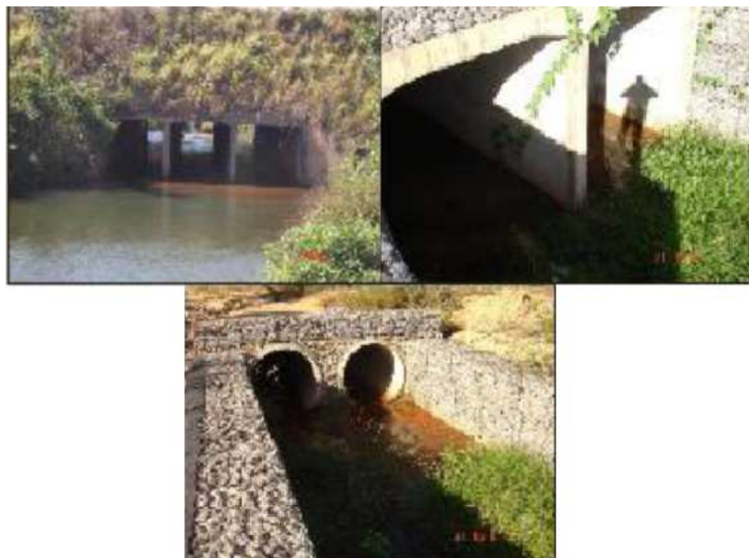
Figura 3-6– Macrodrenagem (galerias de porte)
