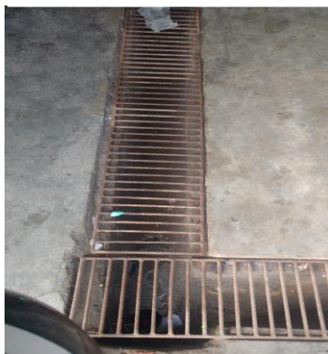
Figura 16- Rede de esgoto exposto em mercado de carnes - Sapeacu
