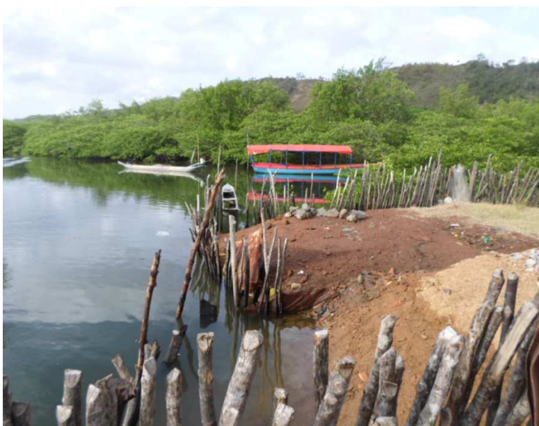
Figura 6- Aterramento dos manguezais para construção de casas
