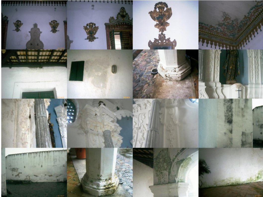
FIGURA 17: Estruturas da Sacristia e externas da OTC com problemas. Fonte: Autora, 2011.
