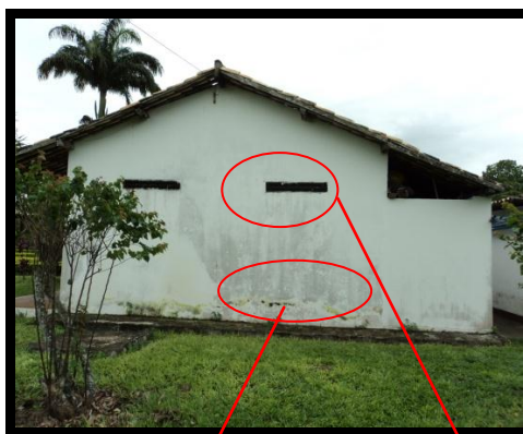
Figura 10- Parede externa da reserva técnica com umidade e entrada ventilação e iluminação natural. Fonte: Autora, 2011.
