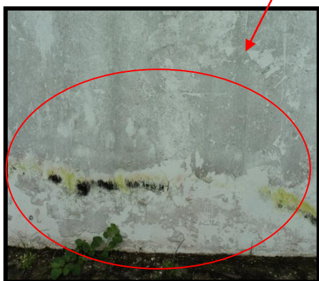
Figura 11- Foto da umidade e mofo na Parede externa da Reserva Técnica. Fonte: Autora, 2011.
